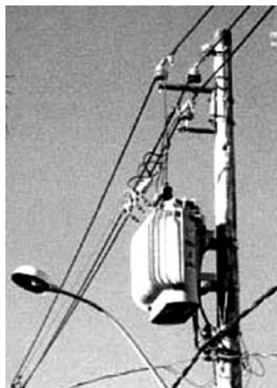
شکل ۳۸- نصب ترانسفورماتورهای هوایی با برق گیرها زیر شبکه کابل فاصله دار
