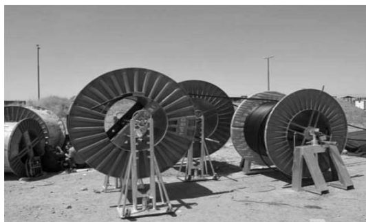
شکل ۸- نمونه‌ای از خرکی‌های نگهدارنده قرقه کابل
